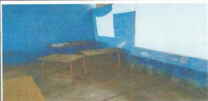
Foto 3: Se observa filtración de agua y mal estado del piso causado por el mal estado de las láminas.
