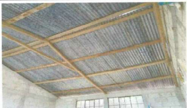
Foto 1: Se observa deterioro en láminas y vigas de madera en el techo.
