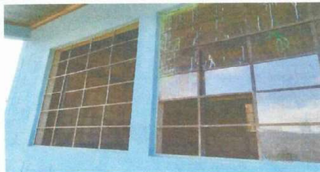
Foto 4: Se observan vidrios faltantes.
