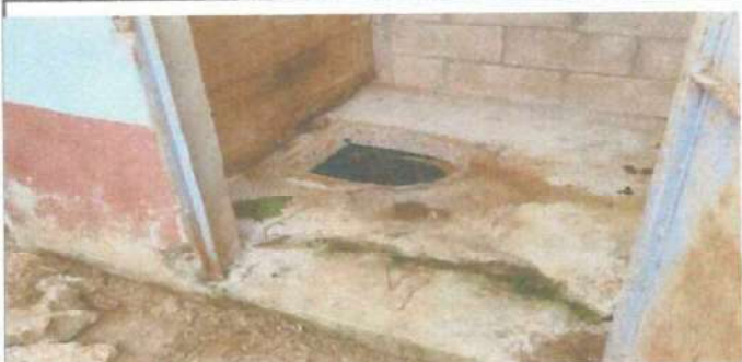
Foto 5: Se observa la falta de letrinas en baños.
