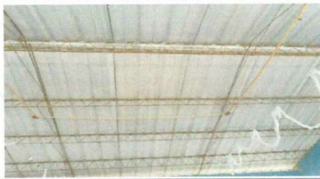
Foto 2: Se Observa deterioro en el hierro del techo.
